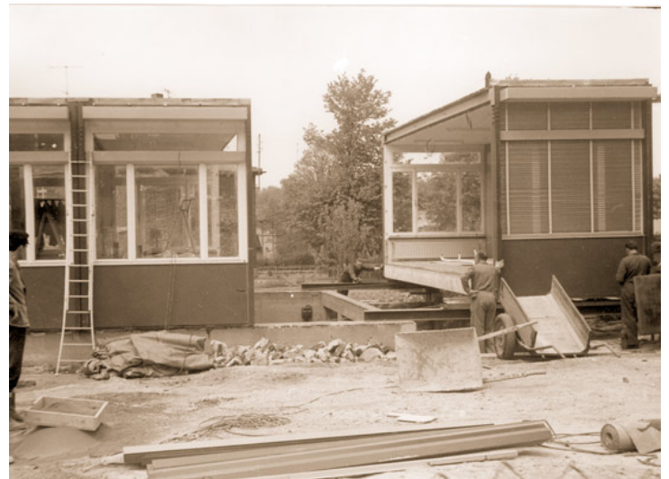
Abb. 5: Bau der Behelfsklassen des neuen Übach-Palenberger Gymnasiums in unmittelbarer Nähe der Volksschule Palenberg. Foto: Stadt
