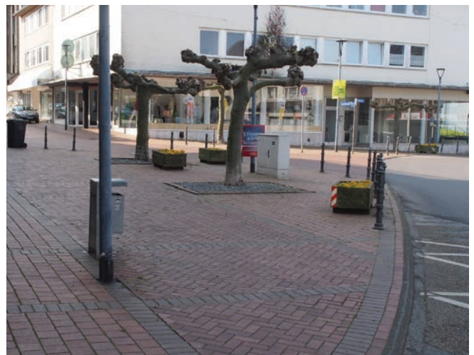
Pflasterung in schlechtem Zustand, Aachener Straße, RaumPlan
