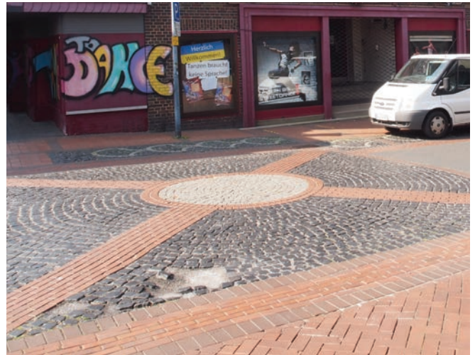
Beschädigtes Pflaster, Kirchstraße, RaumPlan
