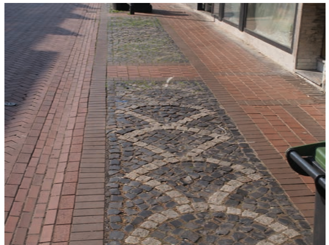
Erneuerungsbedürftiges Pflaster, Aachener Straße, RaumPlan
