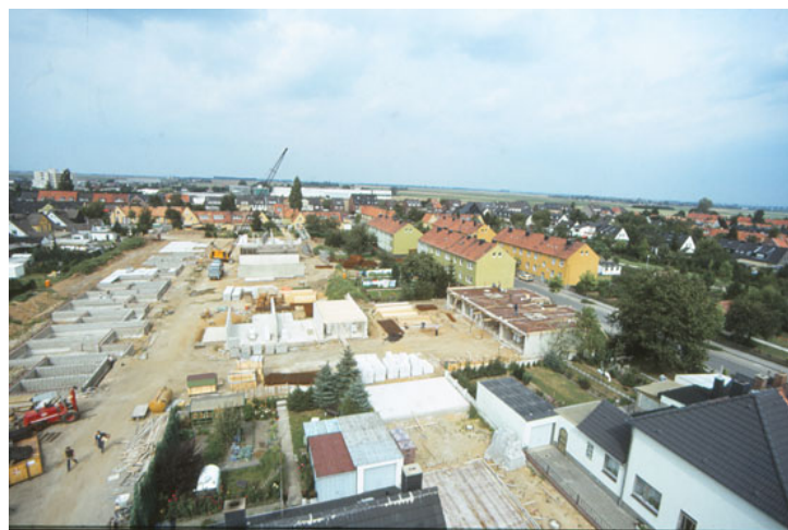
Abb. 6: Rege Bautätigkeit in Boscheln in den ehemaligen Gärten zwischen Lindenstraße und Carl-Alexander Straße. Hier entsteht der Wohnhof "Nordhof". Foto: Stadt
