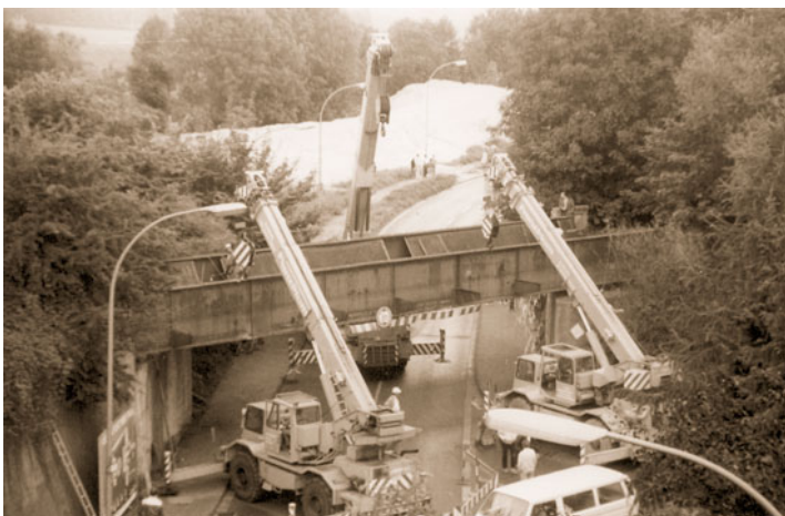
Abb.11: Immer mehr Spuren der Bergbauzeit Übach-Palenbergs wurden beseitigt. Hier wird die Eisenbahnbrücke an der Bahnstraße (Zubringergleis für die Zeche) abgerissen. Foto: Stadt
