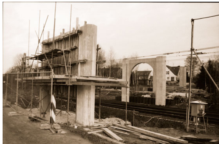
Abb. 18: Blick auf die Bauarbeiten zur neuen Brücke in Palenberg. Hier entstehen die Brückenpfeiler rechts und links der Bahnlinie. Foto: Stadt
