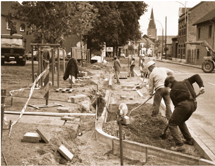
Abb. 16: Bauarbeiten am Hühnermarkt in Scherpenseel im Jahre 1987. Dadurch wurde das äußere Erscheinungsbild dieses kleinen Dorfplatzes deutlich verbessert. Foto: Stadt
