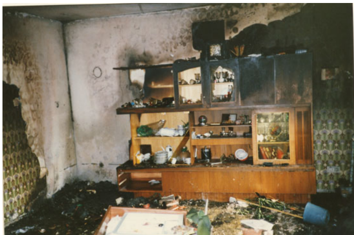
Abb. 19: Zimmerbrand in der Glück-Auf-Straße in Palenberg. Eine 77-jährige Frau starb durch die starke Rauchentwicklung. Foto: Feuerwehr
