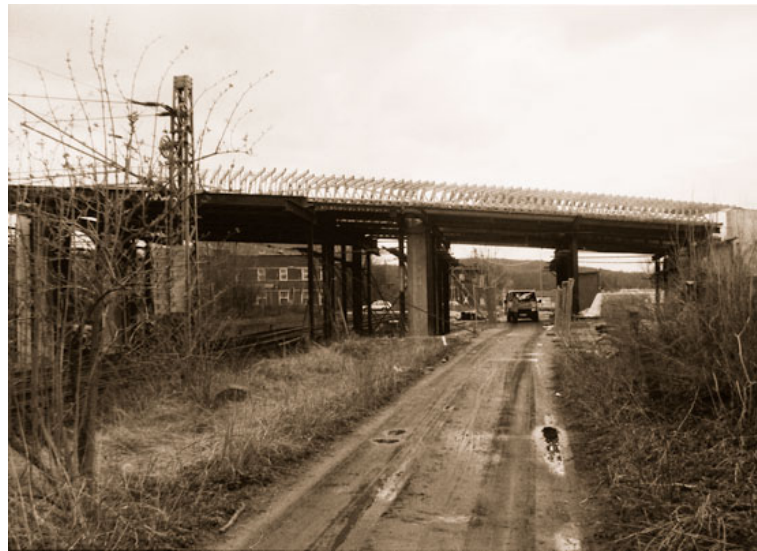
Abb. 8: Ein Blick auf die Baustelle des Brückenbauwerkes in unmittelbarer Nähe der Bahnlinie (1988). Foto: Stadt
