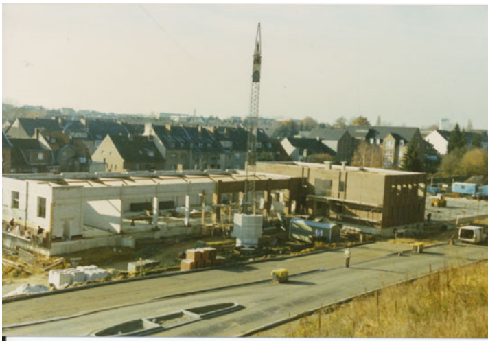
Abb. 11: Zwei große Baumaßnahmen direkt "auf Tuchfühlung": Im Vordergrund die spätere Friedrich-Ebert-Straße, direkt dahinter das neue Feuerwehrgerechthehaus des Löschzuges Übach in der "Stein-auf-Stein-Phase". Foto: Stadt
