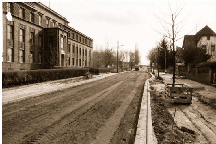
Abb. 6: Die Carlstraße am ehemaligen Carolus-Verwaltungsgebäude wird den künftigen Verkehrsverhältnissen der Nordtangente angepasst. Ein vollkommener Neuausbau war dafür erforderlich. Foto: Stadt
